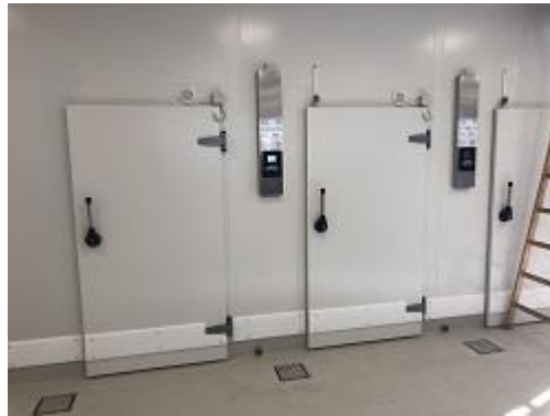
Ansicht Küchenseite Kühlzelle mit EF
